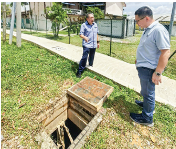
PERIKSA... Wee Hong Seng (kiri) memeriksa kawasan yang didapati tidak mempunyai penutup lubang pembetung yang sempurna.
